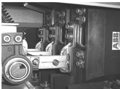
Rys. 1. Analizowane przekładniki prądowe
