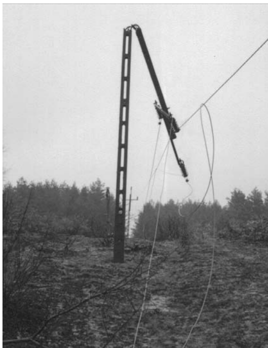
Rys. 2. Uszkodzona linia napowietrzna SN
