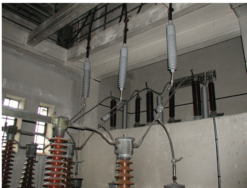
Rys.3. Widok głowic przelaznej linii kablowej 110KV wewnątrz rozdzielni
