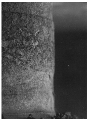
Rys. 1. Zdegradowana powierzchnia osłony silikonowej na pniu izolatora
