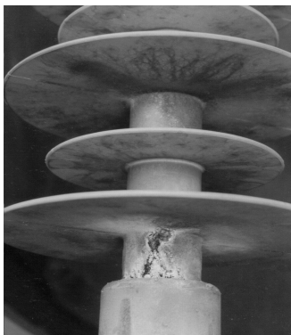
Rys. 2. Głęboka erozja osłony silikonowej, odsłaniająca rdzeń szkło-epoksydowy przy okuciu izolatora
