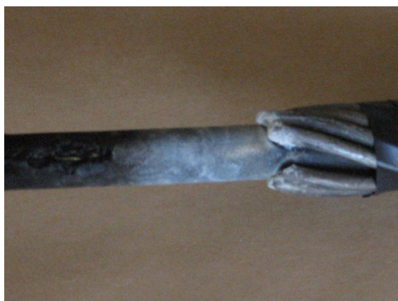
Rys. 8. Ślady erozyjne na powierzchni kabla ADSS
