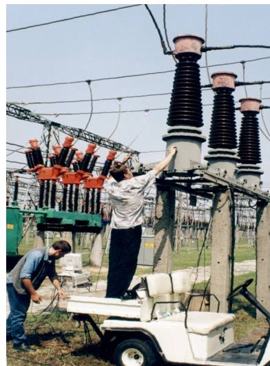
Rys.3. Mocowanie czujników na obudowie przekładnika
