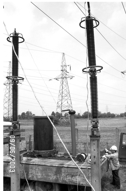
Rys. 1. Stanowisko przewoźne do badania ograniczników przepięć w ZE Tarnów SA
