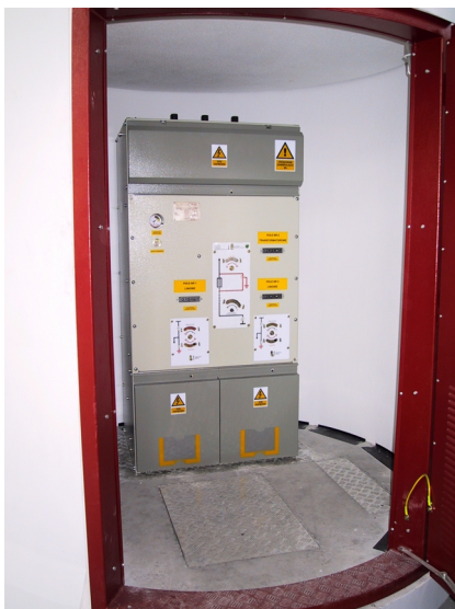
Rys.11. Stacja wieżowa WST rozdzielnicą TPM typu CLTL.
