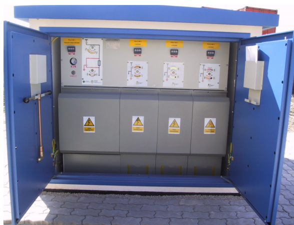
Rys.10. Złącze kablowe z rozdzielnicą TPM typu TLLL.
