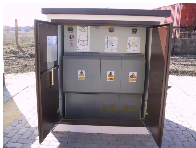
Rys.9. Złącze kablowe z rozdzielnicą TPM typu TLL.
