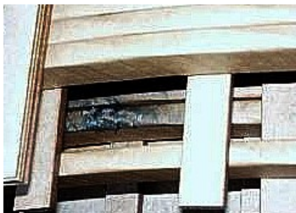
Fot. 1. Ślady wyładowań między uzwojeniami DN autotransformatora 75 MVA
