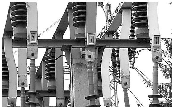
Rys. 10. Instalacja pilotażowa wskaźników PVI na obiekcie ENION S.A. Oddział w Krakowie
