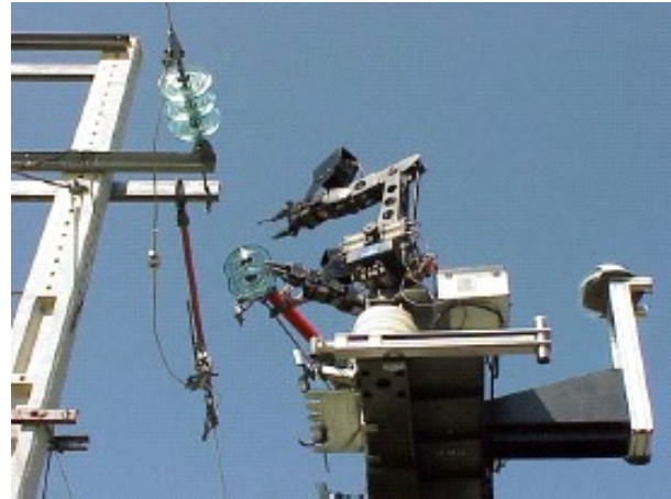
Rys.5. Widok ogólny hiszpańskiego robota do prac pod napięciem
