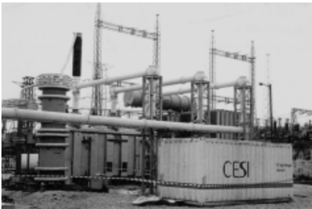
Rys.1. Układ probierczy napięcia przemiennego do próby pomontażowej rozdzielnic
