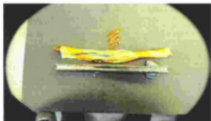
Rys.2. Przykład awarii przewodu OPGW: wzdłużne pęknięcie tuby aluminiowej i wypchnięcie włókien światłowodowych poza oplot
