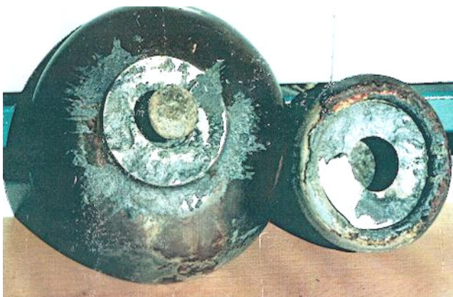
Rys.4. Przykład zniszczenia izolatora wysięgu sieci skompensowanej wskutek nadmiernego ogrzania prądami upływu (wytopienie spoiwa do okuć - widoczne ślady) mylnie interpretowany jako zerwanie izolatora
