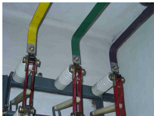
Rys.2. Termogram oraz zdjęcie zacisku odłącznika 15 kV
