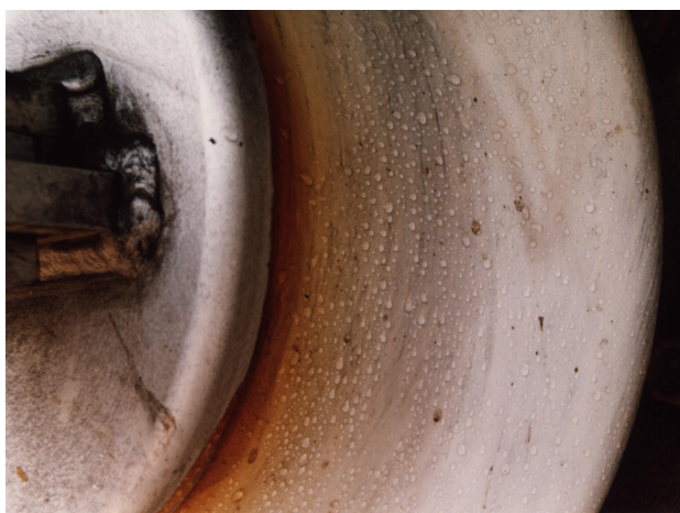
Rys.3. Zwilżone powierzchnie izolatorów przepustowych 6 kV rotund po usunięciu zabrudzeń pyłowych
