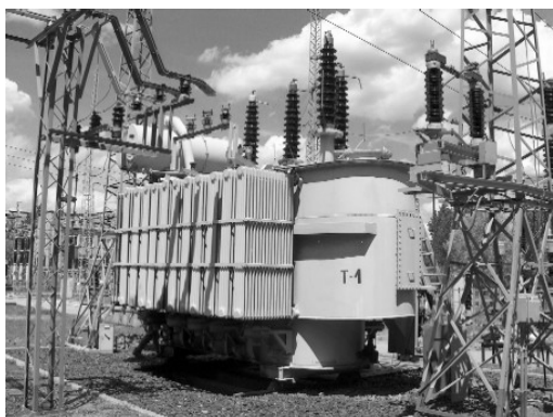
Rys. 1. Widok ogólny transformatora 31.5 MVA, 110/6.6 kV
