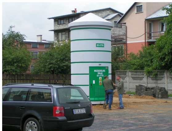
Rys. 5. Stacja w postaci słupa ogłoszeniowego zasilająca osiedle domków jednorodzinnych - Częstochowa
