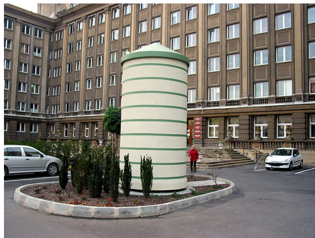
Rys. 1. Stacja transformatorowa w postaci słupa ogłoszeniowego
