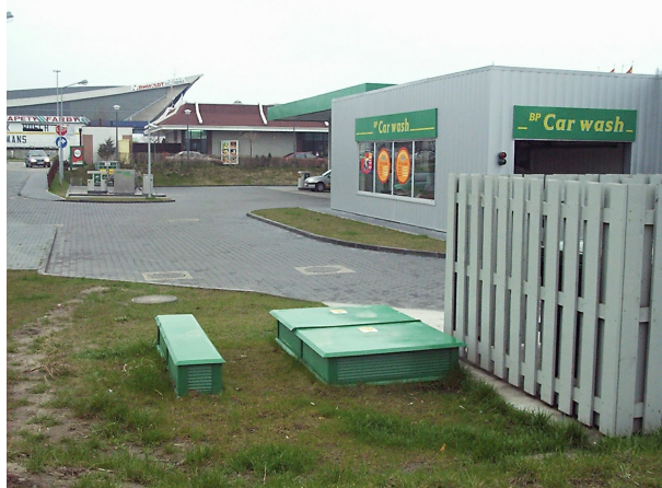
Rys. 10. Widok włazu i wentylacji podziemnej stacji transformatorowej zainstalowanej na stacji paliw w Gdańsku
