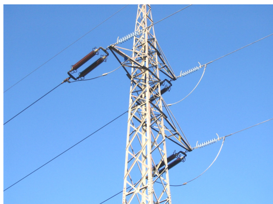
Rys. 2. Zastosowanie różnych typów izolatorów na jednym słupie jednotorowej linii 110kV
