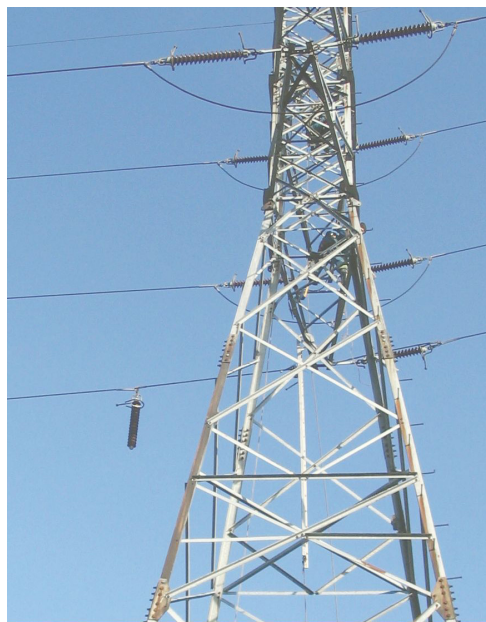
Rys.5. Zerwany izolator długopniowy na słupie mocnym dwutorowej linii 110kV. Widoczny naciągnięty mostek prądowy
