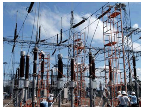
Rys.9. Prace pod napięciem na stacji z platform izolacyjnych – fragment pracy przy wymianie przekładnika napięciowego [13]
