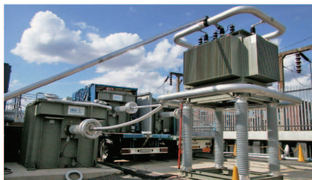
Rys.1. Cztery układy rezonansowe typu ACRF połączone razem (trzy równolegle i jeden szeregowo) w celu uzyskania napięcia probierczego o wartości 280 kV i prądu o natężeniu 240 A, projekt IPH - Londyn 2005 [10]
