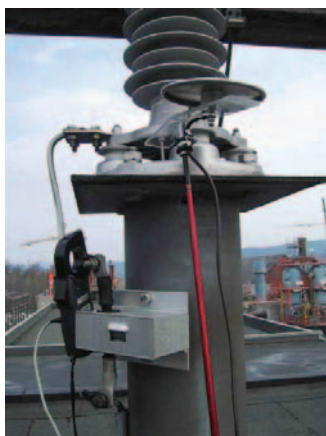
Rys 3. a) Przenośny system LCM II. 1) bezskiernikowy ogranicznik przepięć z tlenku metalu, 2) izolująca podstawa/izolator, 3) przewód uziemiający ogranicznika, 4) postument ogranicznika, 5) cęgowy przekładnik prądowy, 6) pojemnościowa antena/ czujnik pola, 7) teleskopowa podpora anteny, 8) sonda prądowa z wbudowanym czujnikiem temperatury, 9) jednostka LCM II, b) zdjęcie z badania w polu stacji (przetwornik CT musi być zamontowany nad licznikiem przepięć)
