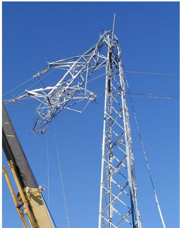
Rys. 4. Stup linii 110 kV uszkodzony z powodu wystąpienia sadzi
