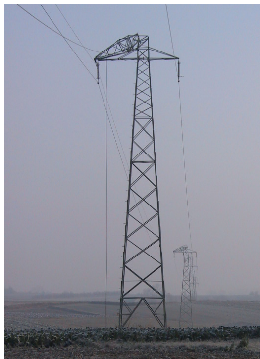
Rys. 5. Stup linii 110 kV uszkodzony w wyniku silnych podmuchów wiatru
