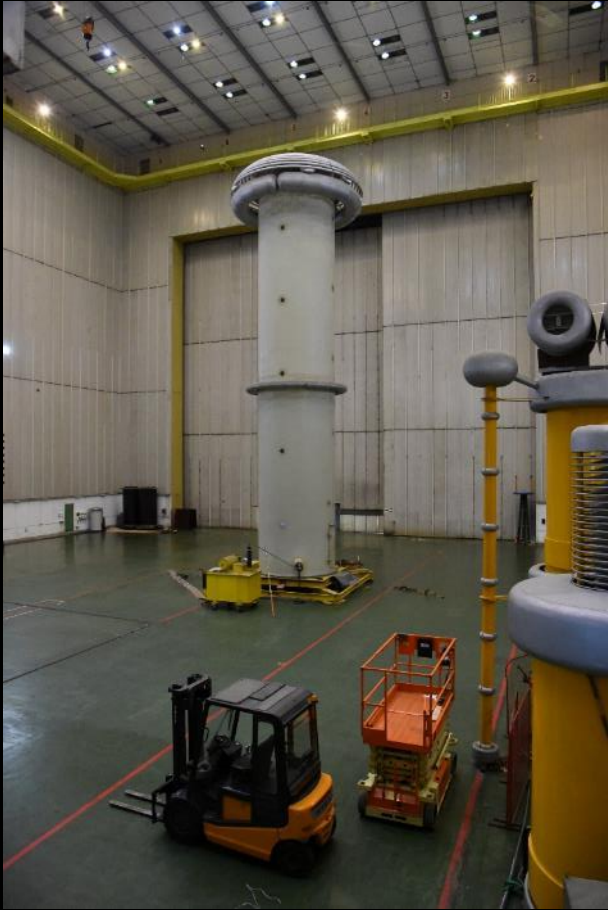
Instytut Energetyki - Hala Najwyższych Napięć
