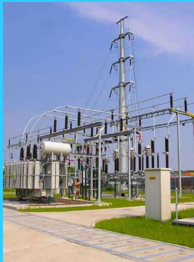
Widok ogólny rozdzielni napowietrznej 110 kV z modułami SIMOVER C i SIMOBREAKER
