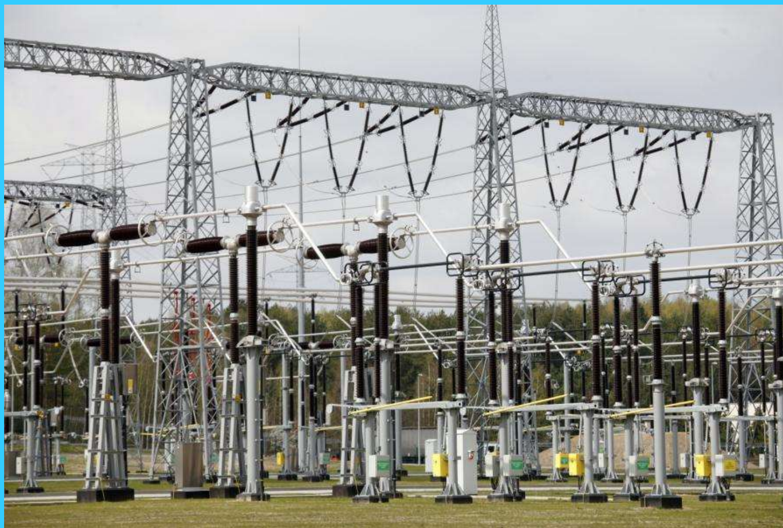
Fragment rozdzielni w stacji 400 kV
