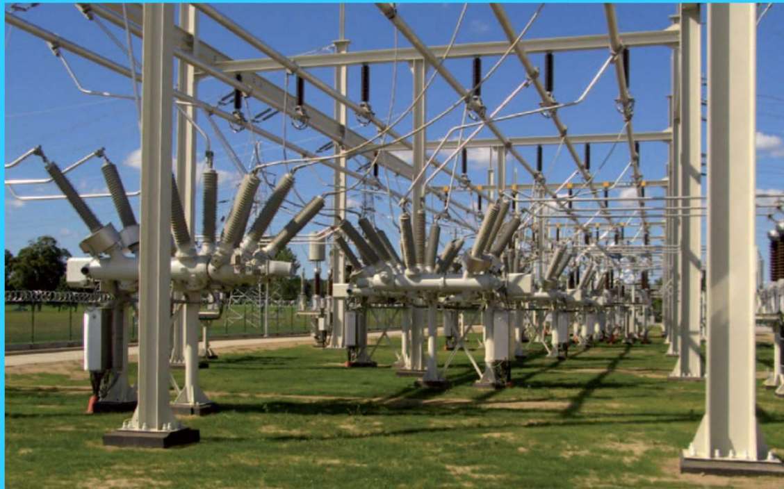
Kompaktowe moduły PASS M0 w rozdzielni 110 kV z podwójnym systemem szyn zbiorczych
