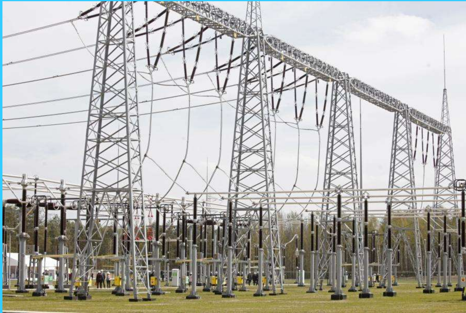
Fragment rozdzielni w stacji 400 kV
