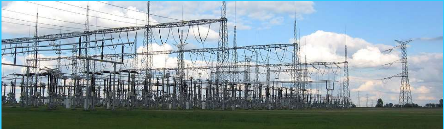
Stacja 400/220/110 kV Mikułowa
