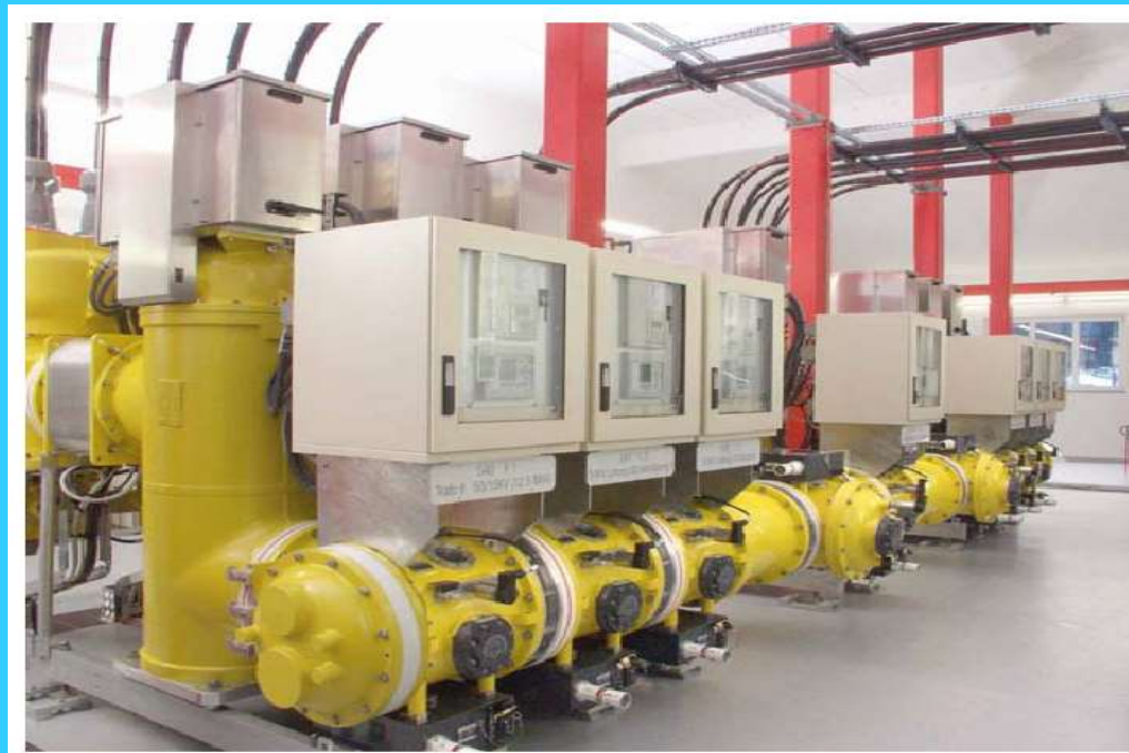
Przykład rozdzielnic 110 kV firmy GE/Alstom
