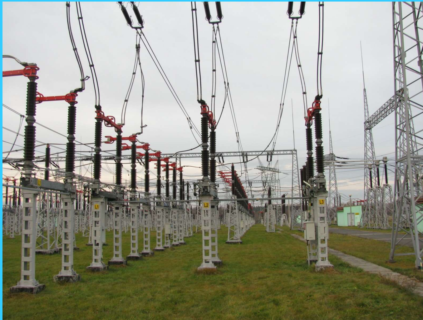
Fragment rozdzielni w stacji 400/220/110 kV
