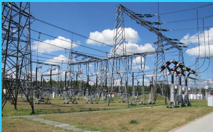
Fragment rozdzielni w stacji 400 kV Grudziądz
